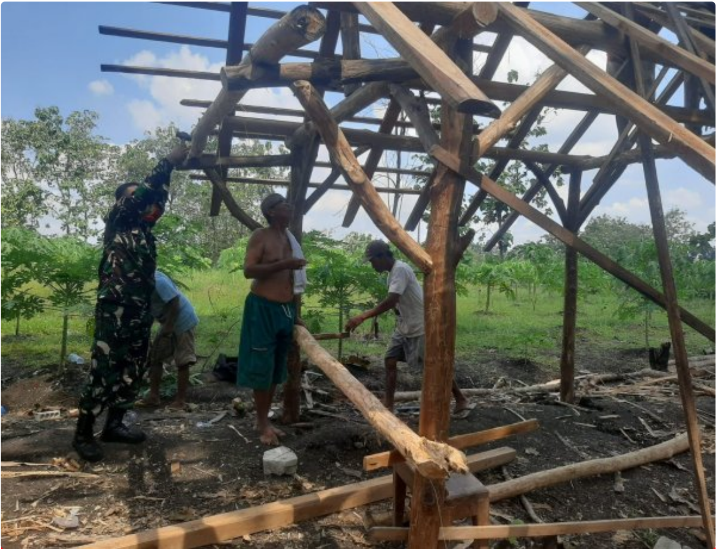
Babinsa Koramil 13/Karangawen Jajaran Kodim 0716/Demak Serda Hartono membantu warga membangun Gubuk di Kebun Bapak Solihin
